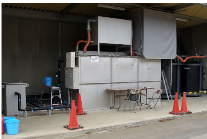
写真：地下水汚染浄化対策施設
