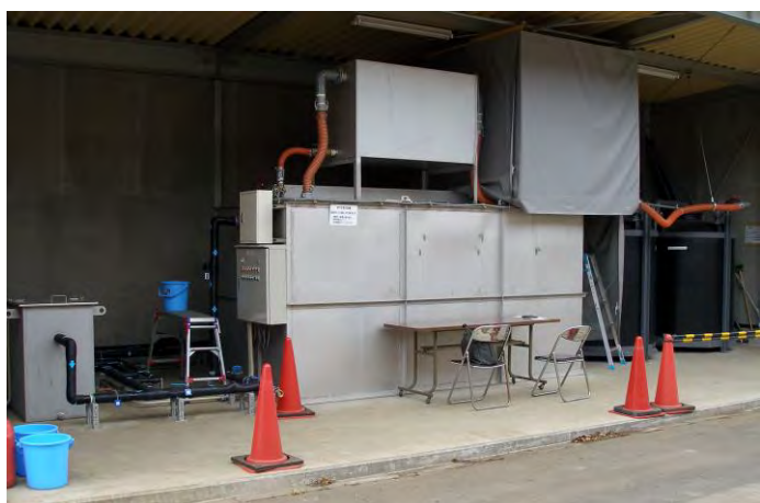
写真：地下水汚染浄化対策施設
