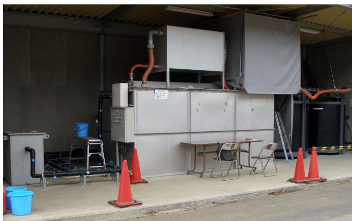
写真：地下水汚染浄化対策施設
