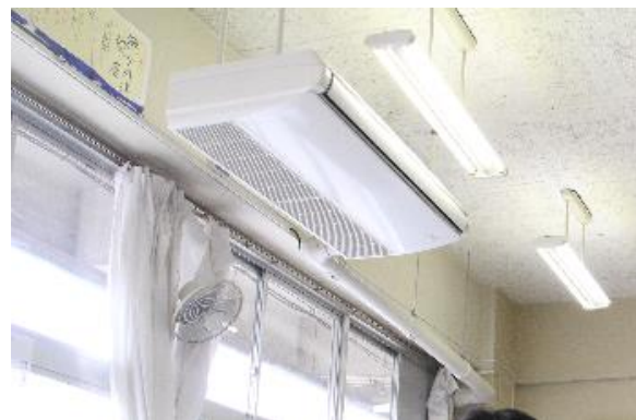
小学校にエアコンを整備
