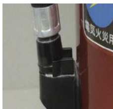
× 消火薬剤の漏れ
