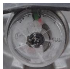
× 指示圧力計の損傷
