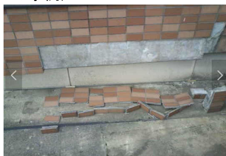
外壁の剥離した事例
