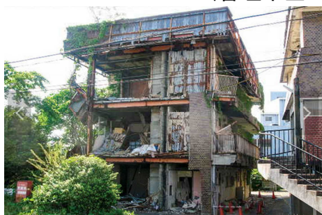
建物が損傷し廃墟化した事例
