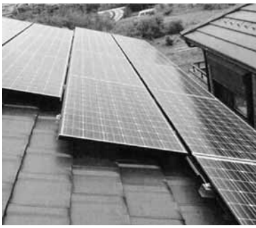
屋根に設置した太陽電池パネル
