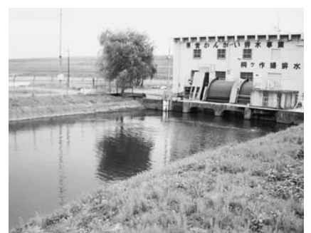
桐ヶ作揚排水機場はポンプ稼働時間を拡大
