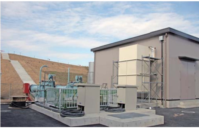
排水ポンプ設置で東宝珠花を中心とした浸水被害を大きく改善
