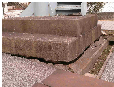
写真；地盤沈下により相対的に 抜け上がった基礎
