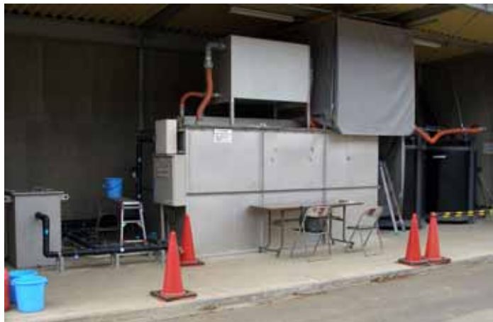
写真：地下水汚染浄化対策施設
