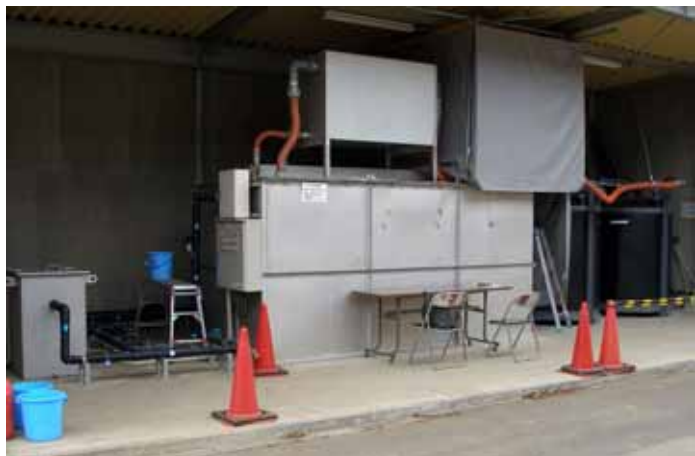
写真：地下水汚染浄化対策施設
