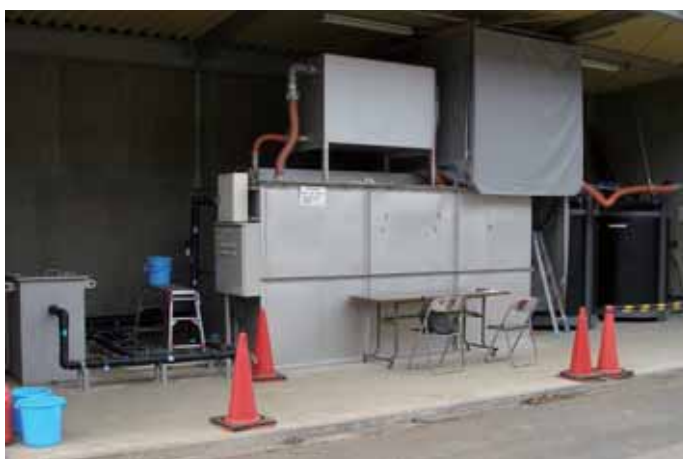
写真：地下水汚染浄化対策施設
