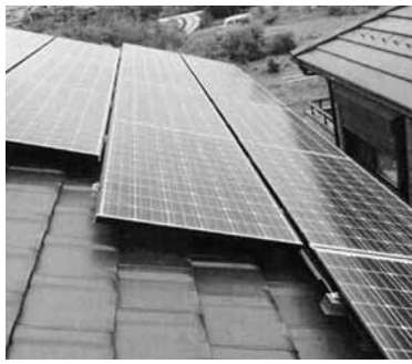
屋根に設置した太陽電池パネル
