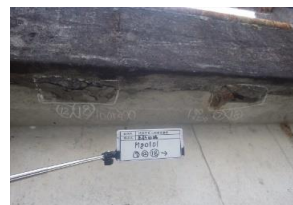
主桁の鉄筋露出
