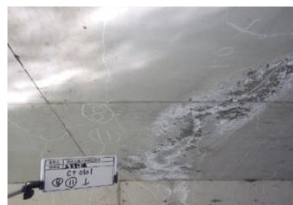
床版のひびわれ
