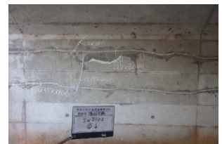
橋台のひびわれ
