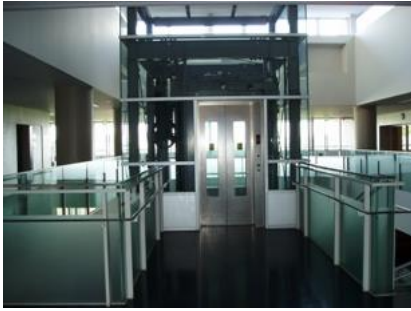
関宿総合公園体育館エレベーター
