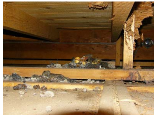
天井裏のフン被害
