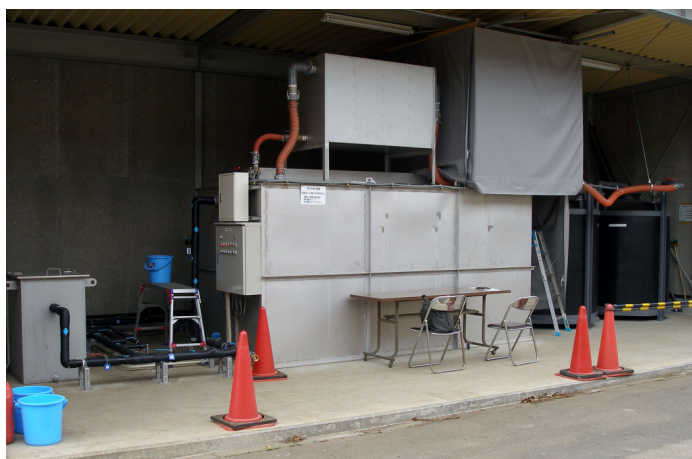
写真：地下水汚染浄化対策施設
