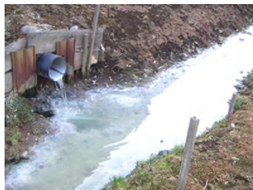
写真；排水路の水質汚濁事故
