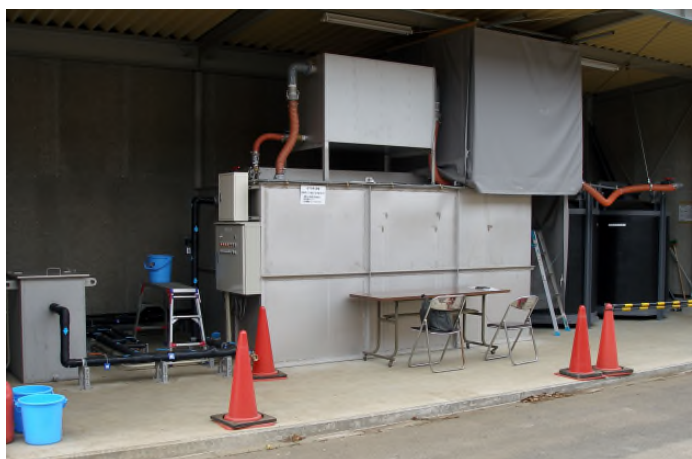
写真：地下水汚染浄化対策施設
