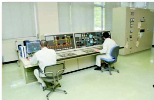
中根配水場 操作室
