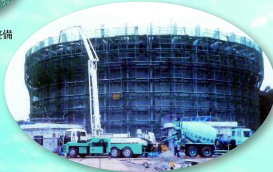
新たな配水施設の整備
