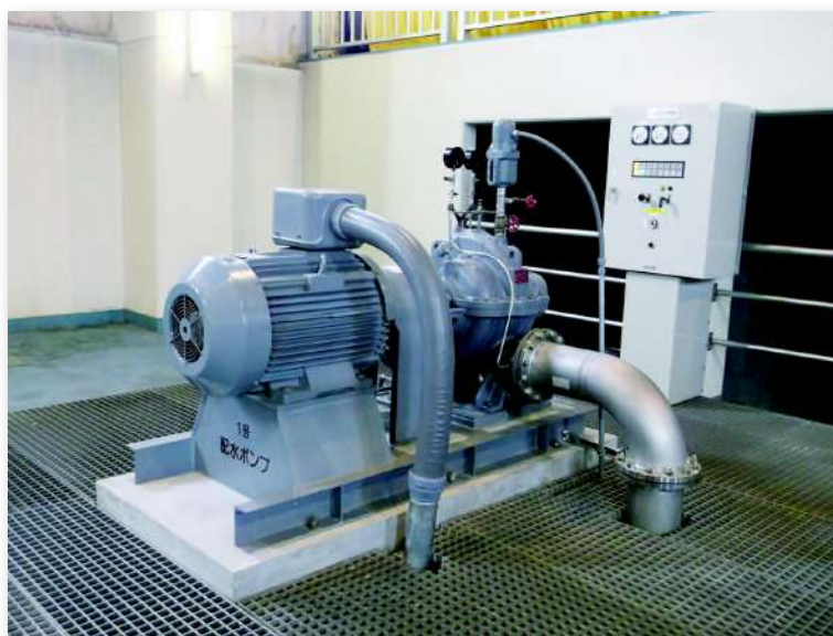
省エネ型ポンプ
