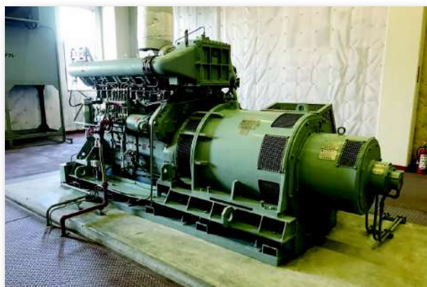
東金野井浄水場 自家発電設備
