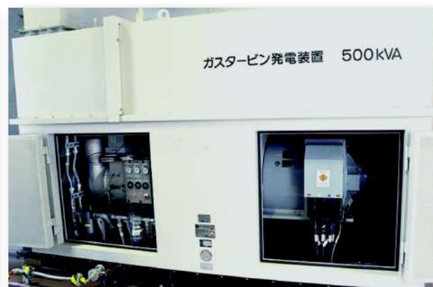
中根配水場 自家発電設備
