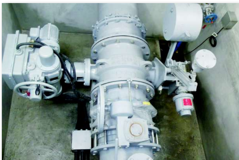
東金野井浄水場 緊急遮断弁
