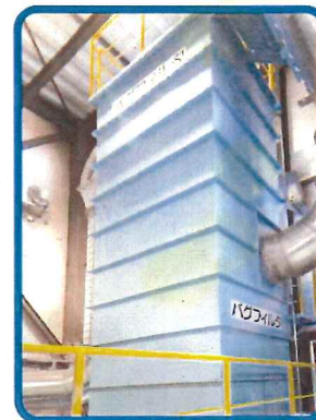
バグフィルタ 細かな粉じんを取り除きます。
