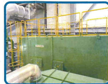
活性炭脱臭塔 臭いを取り除きます。
