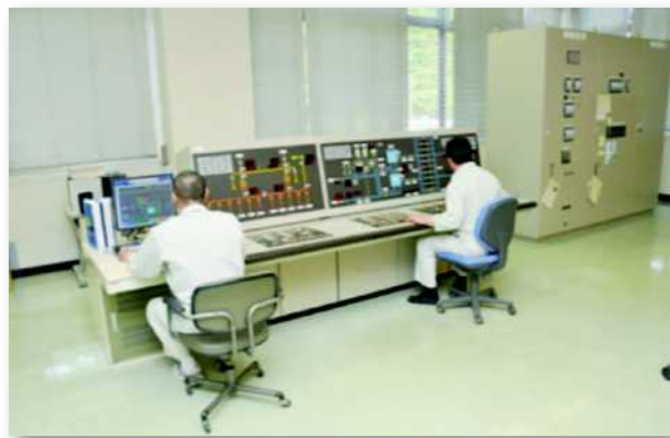
中根配水場 操作室
