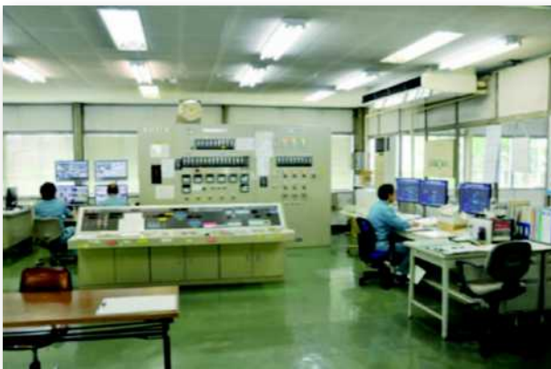
上花輪浄水場 各種情報が集中している操作室
