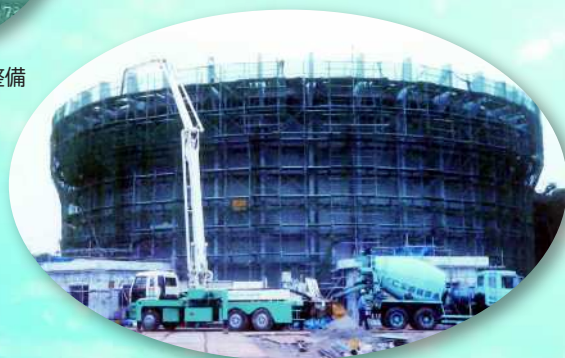
新たな配水施設の整備
