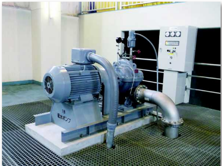
省エネ型ポンプ
