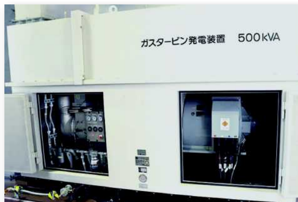
中根配水場 自家発電設備
