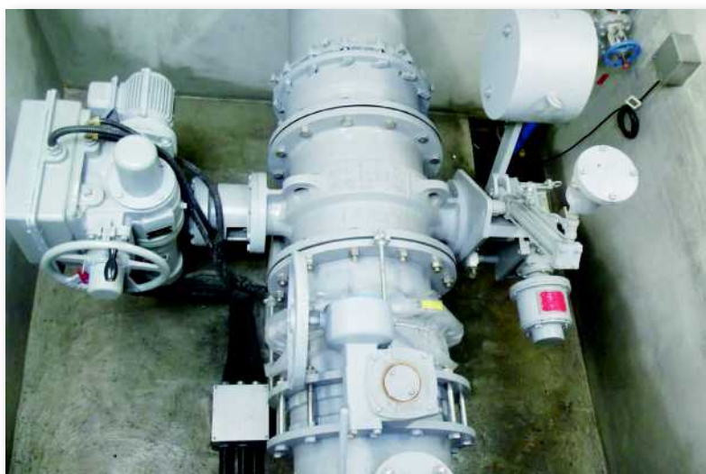
東金野井浄水場 緊急遮断弁
