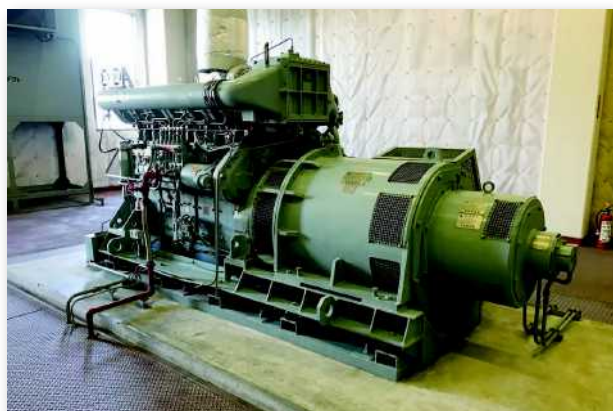
東金野井浄水場 自家発電設備
