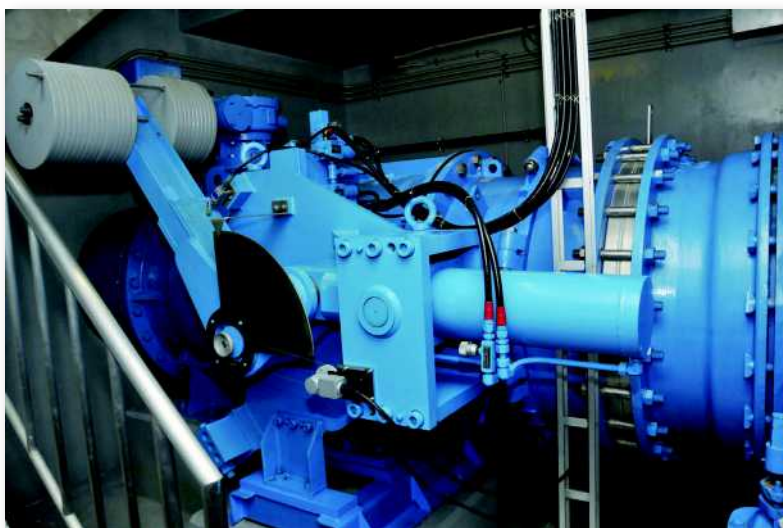
中根配水場 緊急遮断弁
