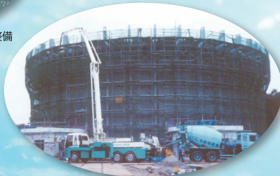
新たな配水施設の整備
