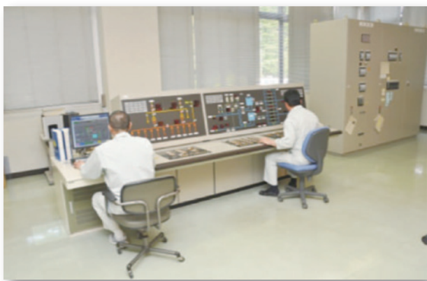
中根配水場 操作室
