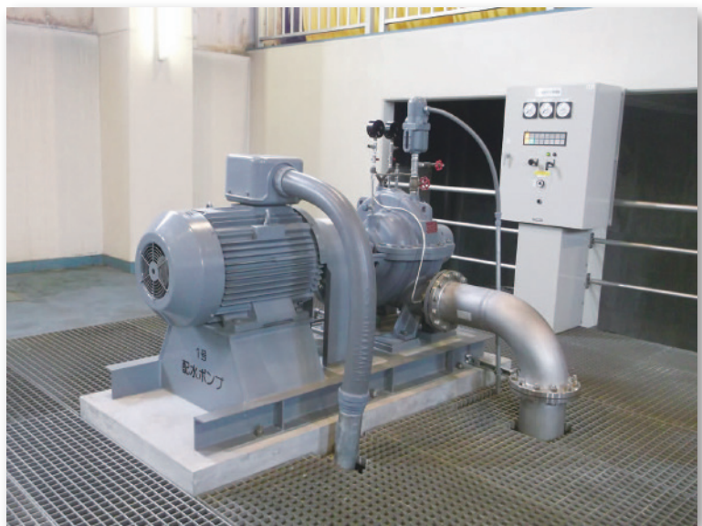
省エネ型ポンプ
