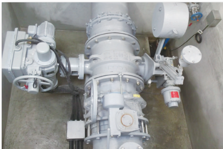
東金野井浄水場 緊急遮断弁
