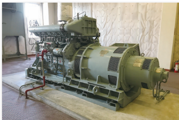
東金野井浄水場 自家発電設備
