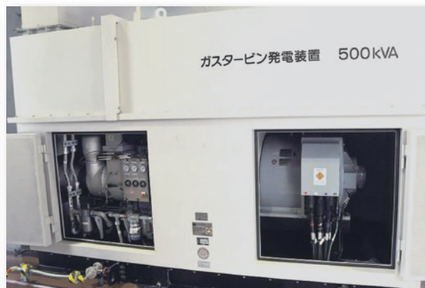
中根配水場 自家発電設備
