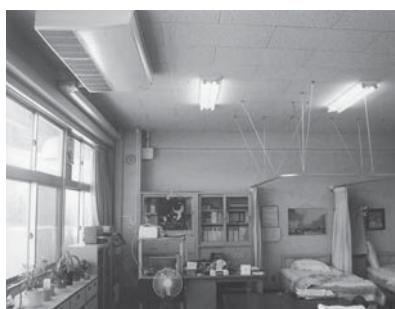
保健室に設置されているエアコン
