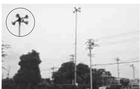
同報系防災無線（関宿総合公園付近）
