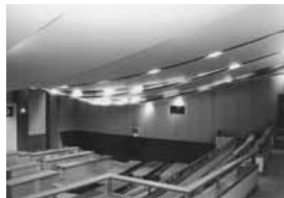
本会議場天井が一部破損
