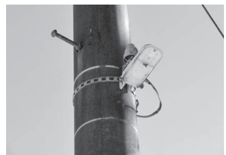
市内に設置されている防犯灯
