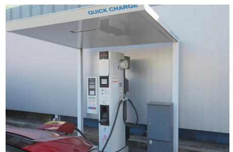
急速充電設備(千葉日産自動車(株)野田店)
