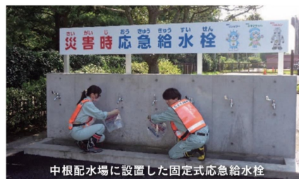
中根配水場に設置した固定式応急給水栓
