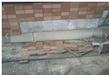
外壁の剥離した事例
