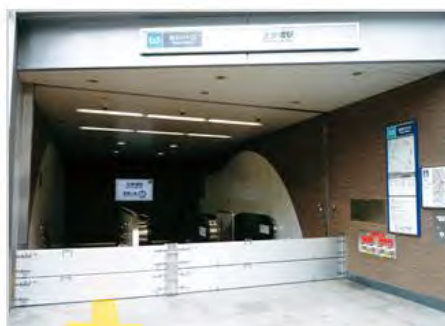
駅出入口に設置した止水板
