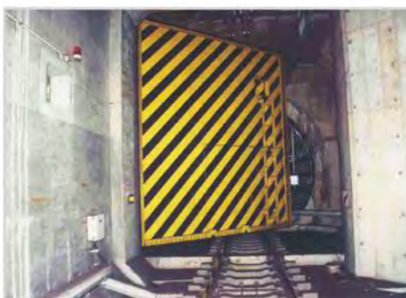
トンネル内防水ゲート
