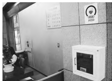
市役所1階にもAEDを設置
