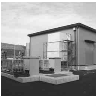
毎秒1トン排水可能なポンプを2台設置
