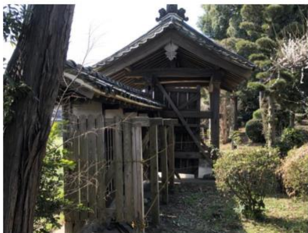
2-3 修理前脇塀右背面
