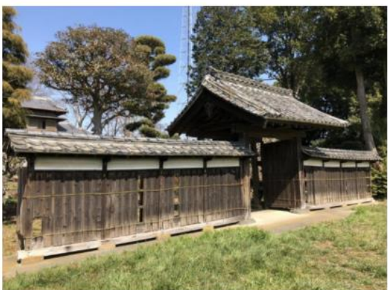
1-3 修理前正側面
