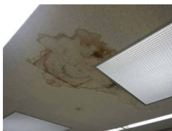
天井漏水(体育館)
