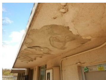
躯体劣化・剥落(野球場管理棟)
